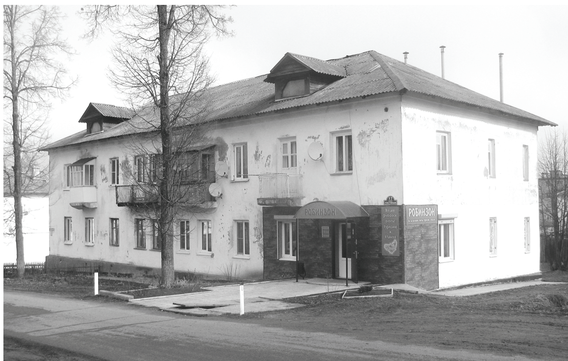
Многоквартирный дом №17 по улице Гостинной в поселке Думиничи, в котором в 2018 году будет отремонтирована крыша.
